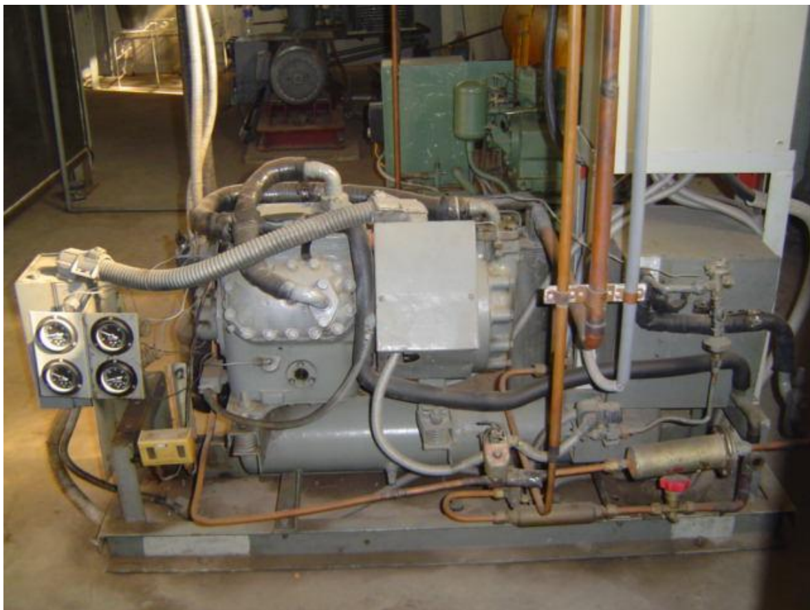
Hệ thống lạnh cấp đông (-28 đến -45 0 C)
