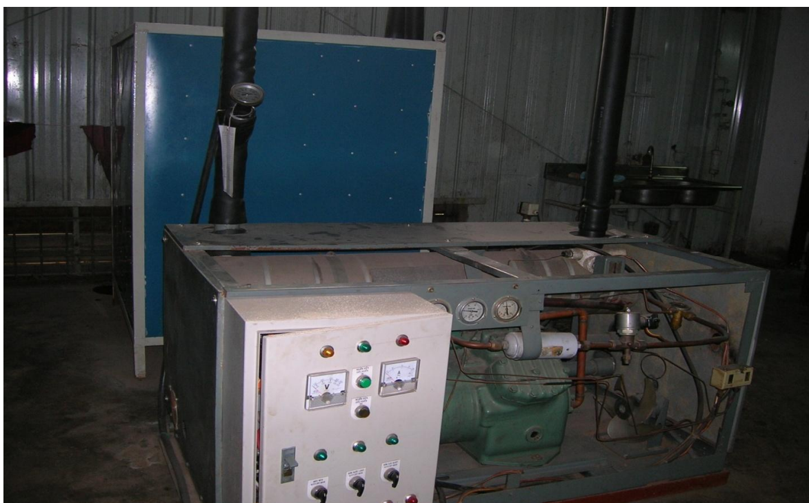
Hệ thống điều hoà không khí Water Chiller
