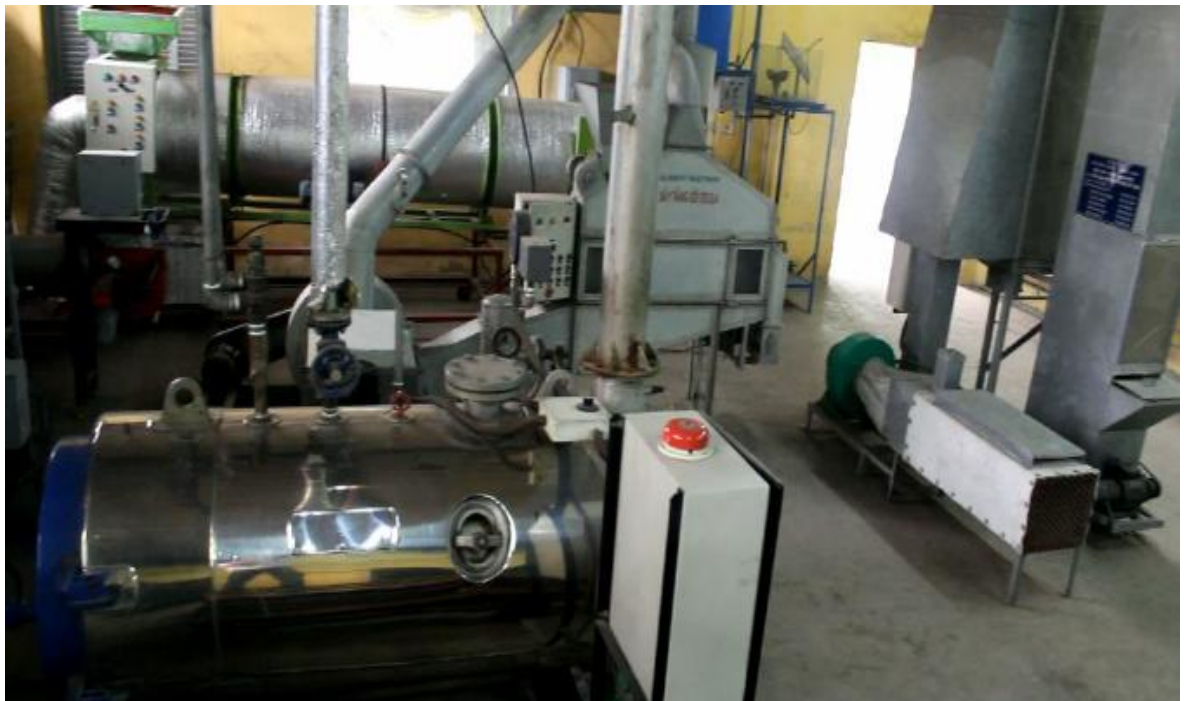
Lò hơi, máy sấy thấm, máy sấy tầng sôi và thùng quay
